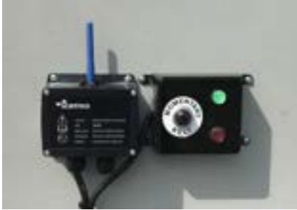
SISTEMA DE CINTA TRANSPORTADORA OPERATIVO
