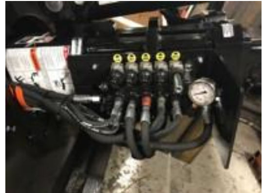
Fig. 3-1, Controles hidráulicos montados sobre un poste central
