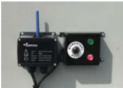
SISTEMA DE CINTA TRANSPORTADORA NO OPERATIVO
